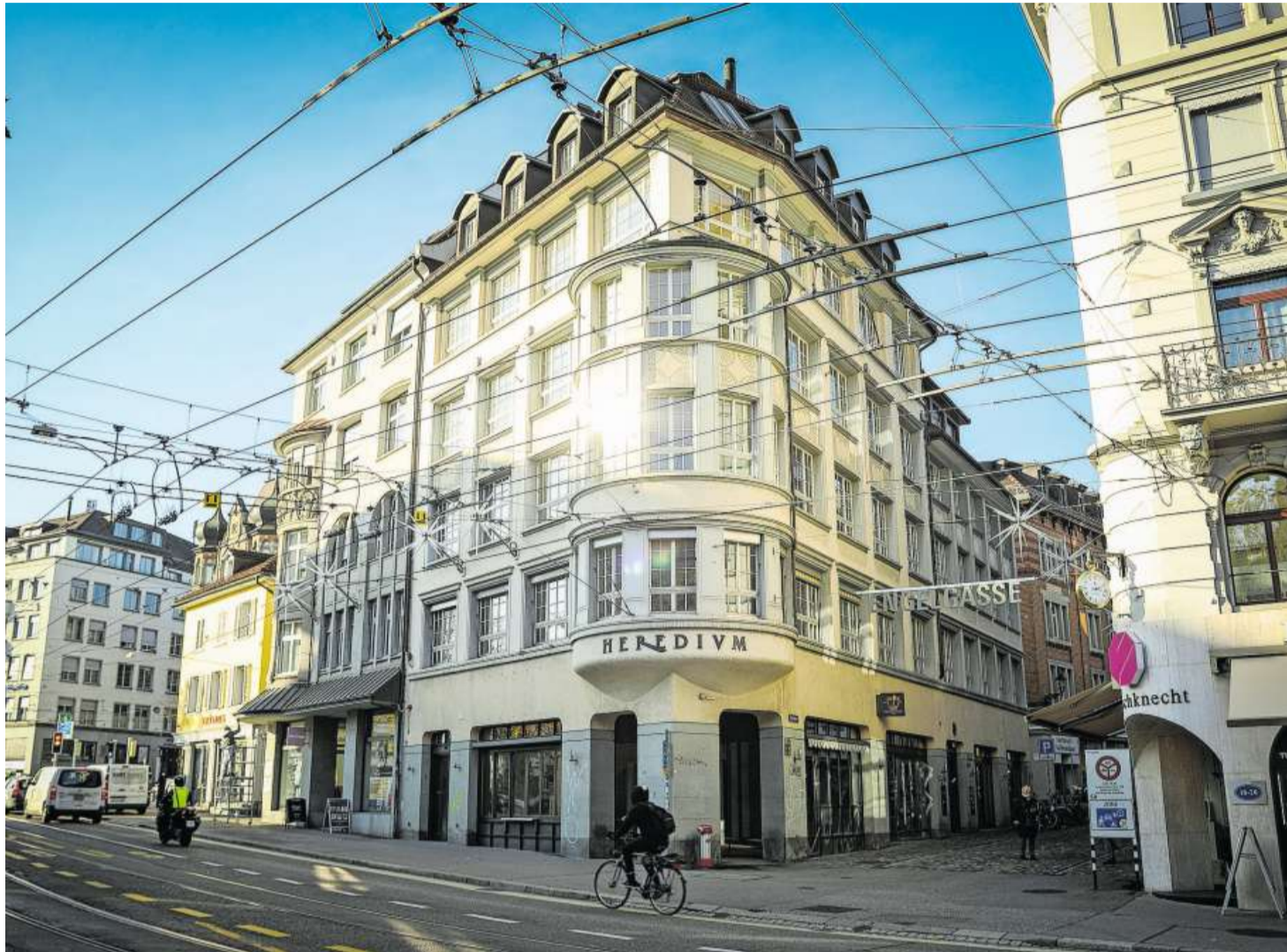
Heute steht vor dem Gebäude am Marktplatz 22 ein Gerüst, das das ganze Trottoir blockiert.
